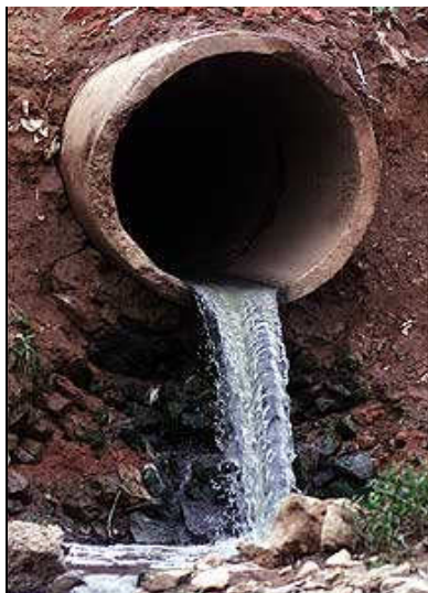
a) despejo direto de esgoto
