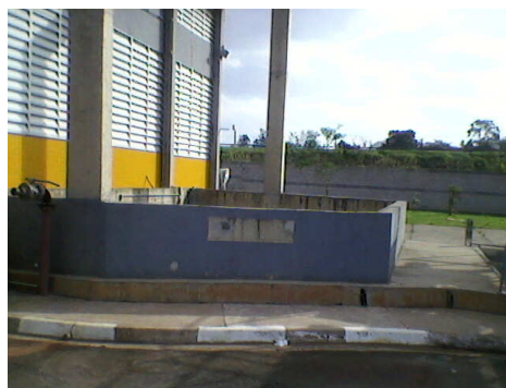
A) Tanque de armazenamento
