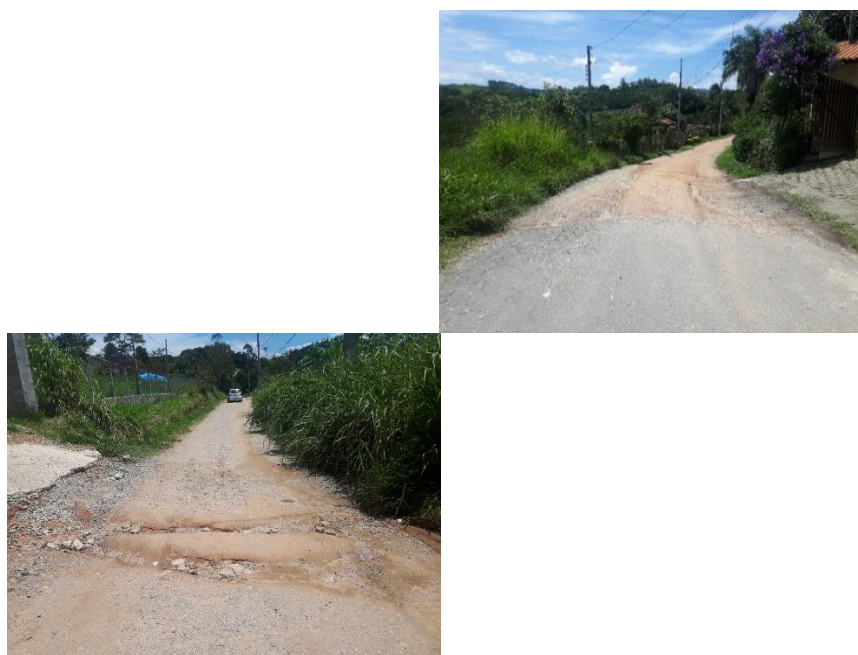
Figura 38 - Erosão linear provocada por rampas de residências. Fonte: Autor (2018).
