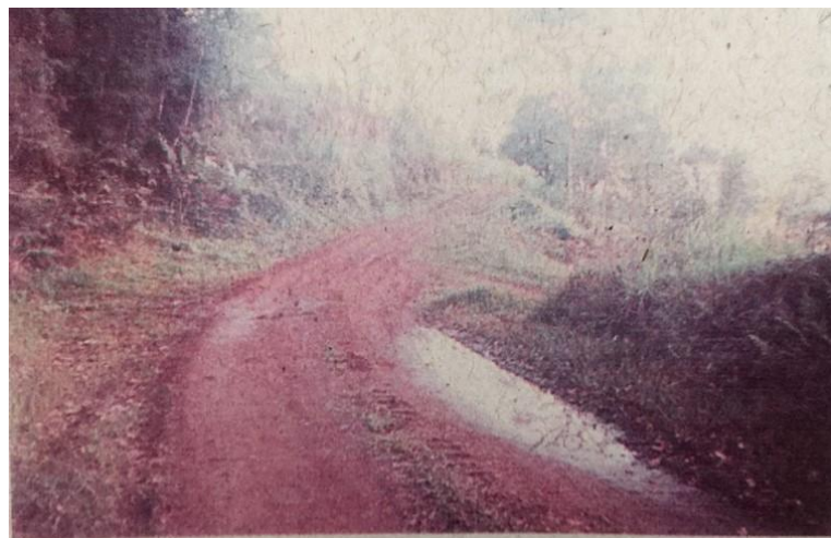
Figura 11 - Acúmulo de água em estrada de terra. Fonte: Baesso e Gonçalves (2003).
