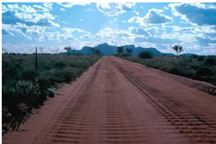
Figura 12 – Corrugações. Fonte: Autor (2017).
