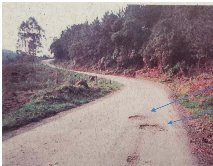
Figura 14 – Buracos na pista Fonte: Baesso e Gonçalves (2003).
