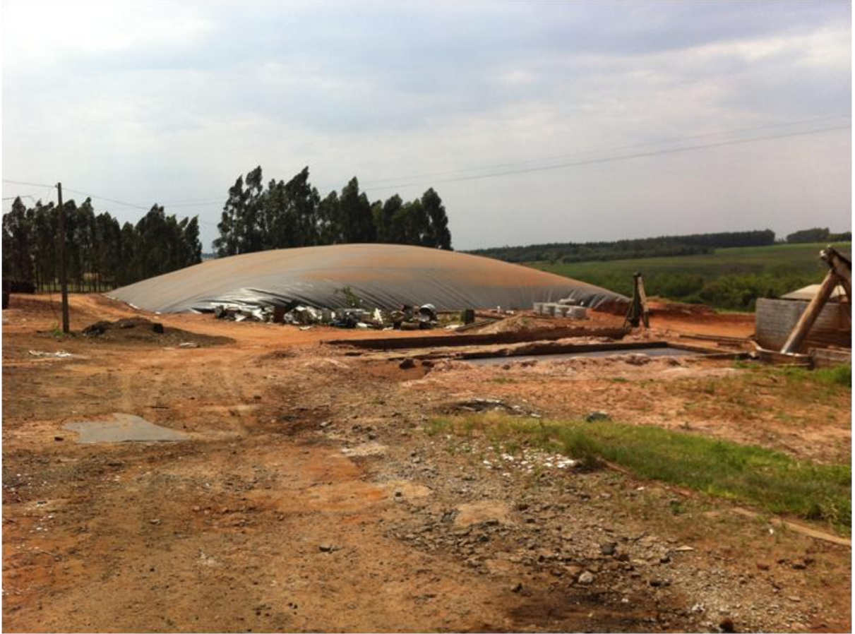
Figura 6 – Lagoas de estabilização de tratamento de efluentes coberta com PEAD e com mangueiras enterradas para captação do biogás na Amidos Pasquini
