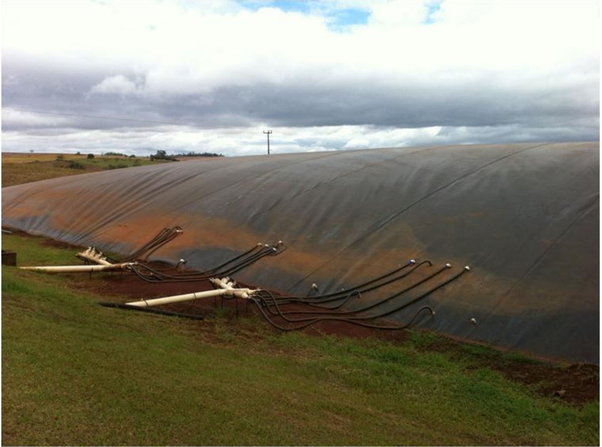
Figura 5 – Lagoas de estabilização de tratamento de efluentes coberta com PEAD e com mangueiras aparentes para captação do biogás na Amendonaria C. Vale
