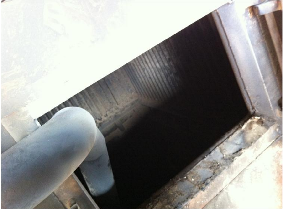
Figura 8 – Entrada da Câmara de combustão para alimentar a caldeira da fecularia
