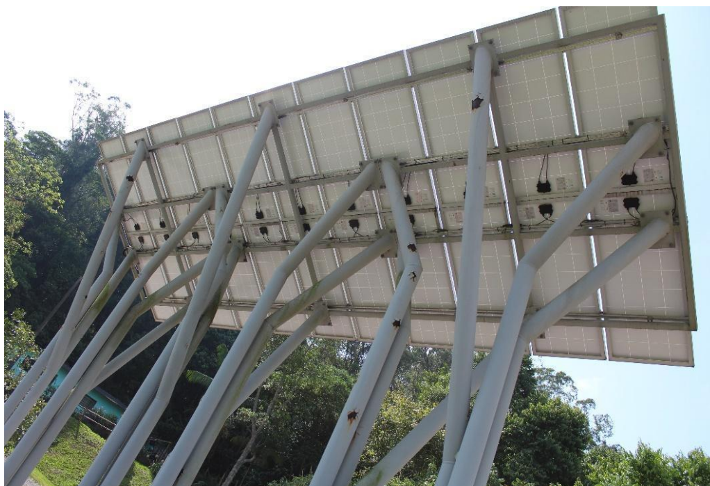
Figura 30. Parte Inferior da infraestrutura do sistema solar fotovoltaico
