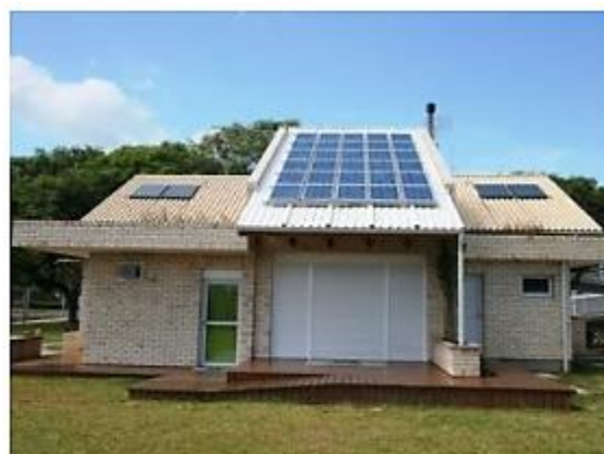
Figura 12. Sistema fotovoltaico concomitante Fonte: Recuperado de “Desenvolvimento de conversores estáticos para sistemas FV autônomos” de Imhoff (2007).
