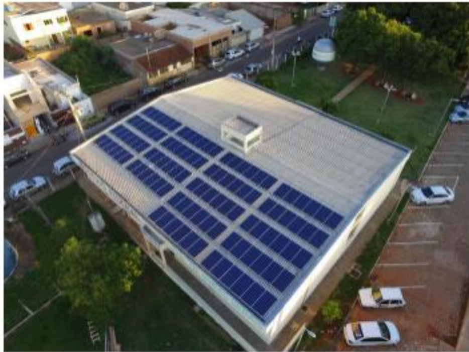
Figura 19. Usina Fotovoltaica instalada no IFSul - Campus Muzambinho.
