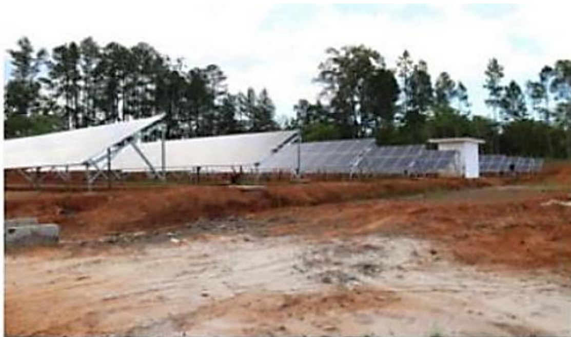
Figura 18. Usina Fotovoltaica Instalada na UFES.
