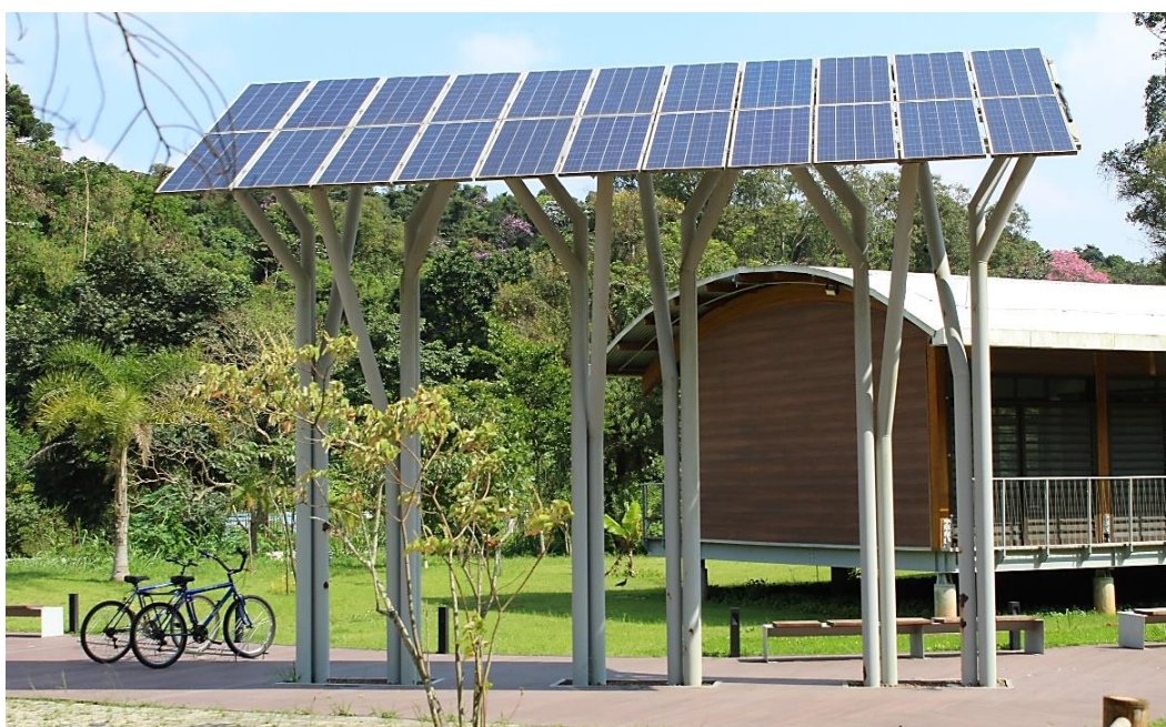
Figura 29. Infraestrutura do sistema solar fotovoltaico
