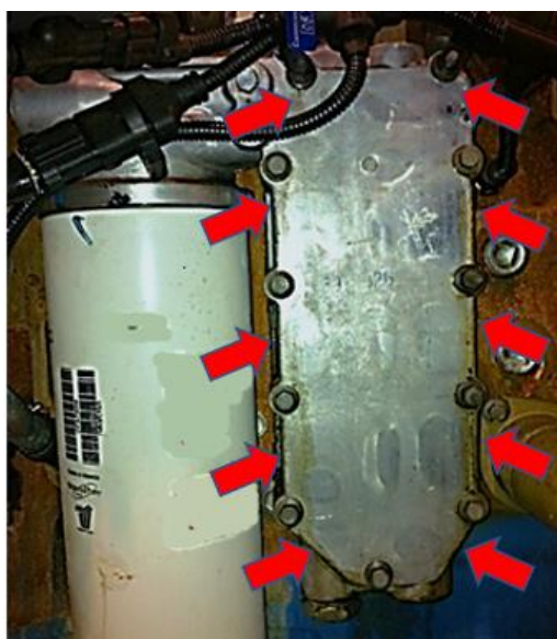
Figura 21 - Vazamento de óleo pela furação dos parafusos
