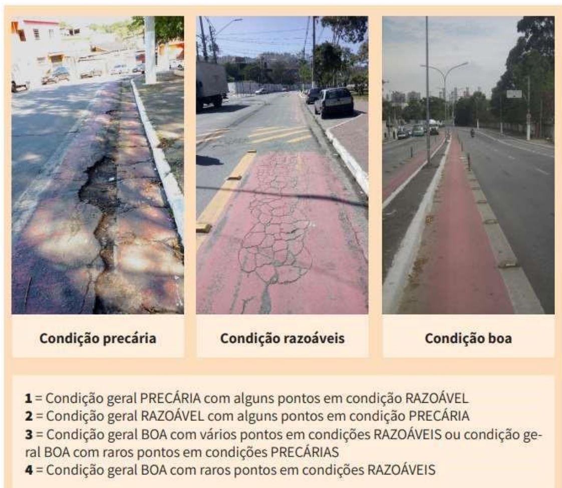
Figura 2.0.1 - Avaliação das diferentes condições de pavimento observadas pela Auditoria
