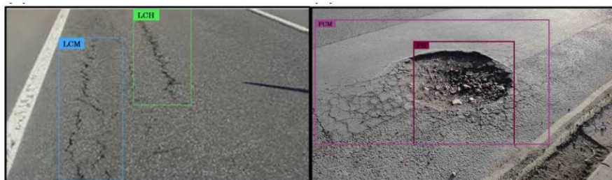
Figura 3: Exemplo de anomalias em vias públicas, como rachaduras e buracos
