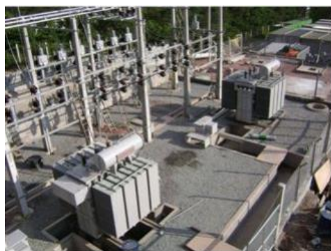
Figura 19: Subestação da UTE – São João
