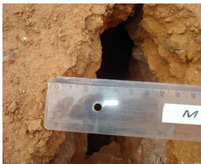
Figura 9: Trinca de aproximadamente 9 cm.
