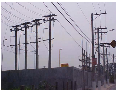
Figura 15: Subestação de Perus
