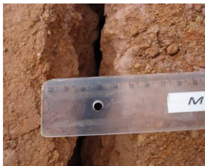
Figura 8: Trinca de aproximadamente 4 cm.
