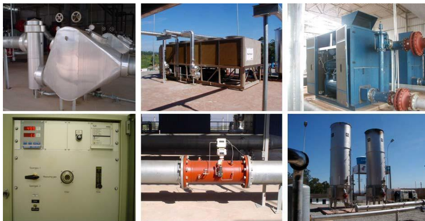
Figura 12: Equipamentos utilizados na usina de captação de biogás
