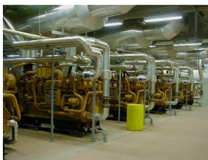
Figura 13: Conjunto de motogeradores instalado na UTE - Bandeirantes
