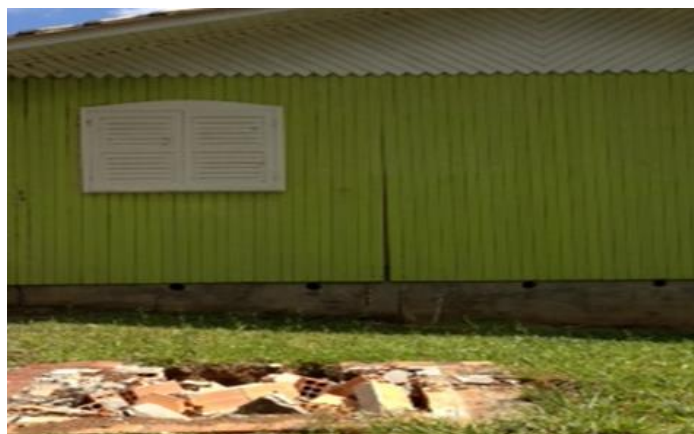
FOTOGRAFIA 6 - Rachaduras em residência decorrente da subsidência
