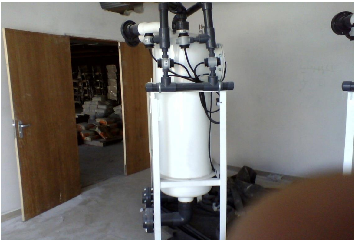
Figura 13 - Sala do compartimento do equipamento
