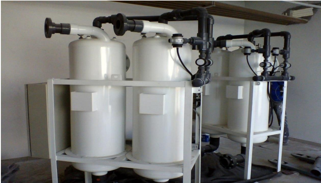
Figura 4-Reservatórios do equipamento instalado
