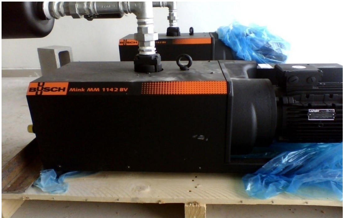
Figura 7- Bombas de vácuo instaladas (visão lateral)
