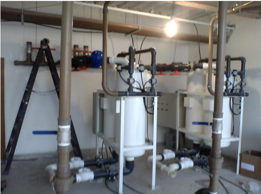
Figura 8 - Equipamento completo instalado
