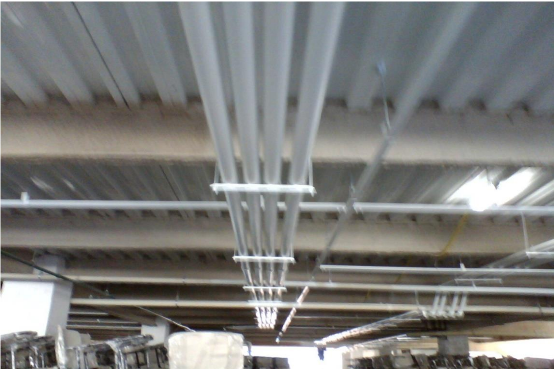
Figura 11 - Tubulação (colunas) de sucção de esgoto
