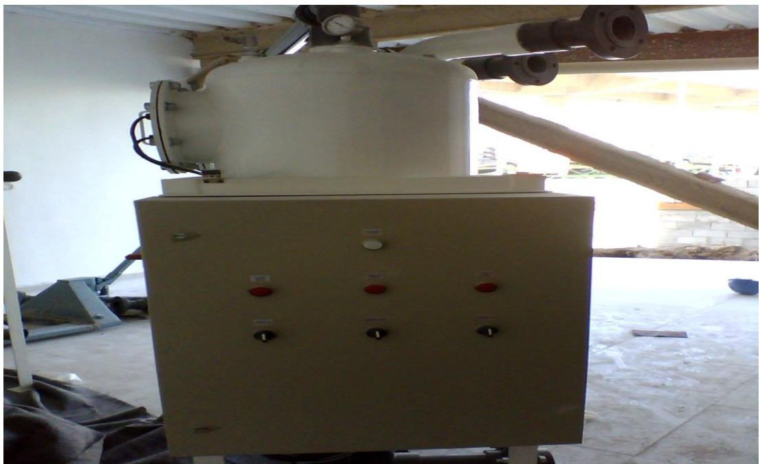
Figura 5-Painel do equipamento instalado
