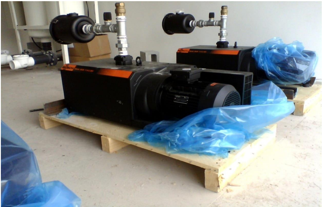
Figura 6- Bombas de vácuo instaladas
