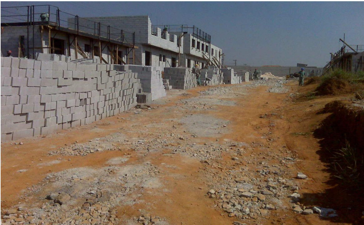
Figura 58. Imagem da reutilização dos RCC na melhoria das vias internas da obra. Fonte: PGRCC – Obra 3 – Suzano.
