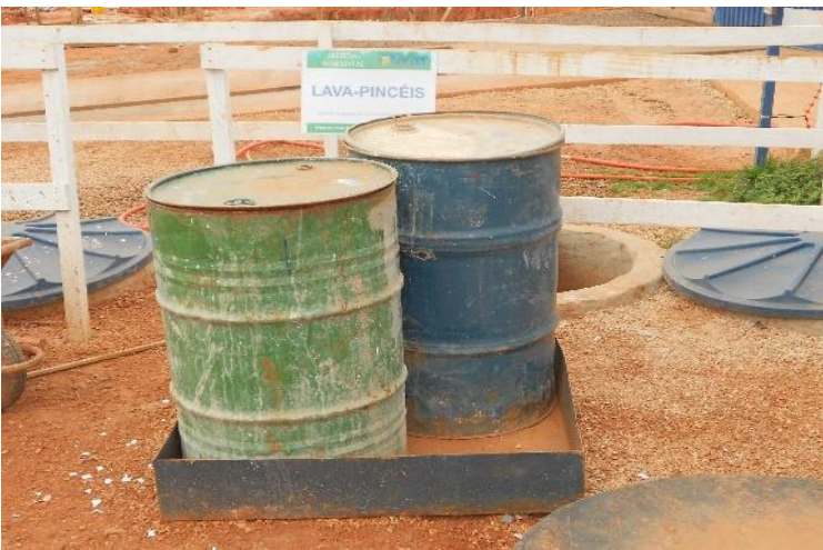
Figura 57. Imagem dos tambores para lavagem de pincéis e retenção de efluentes. Fonte: PGRCC – Obra 3 – Suzano.
