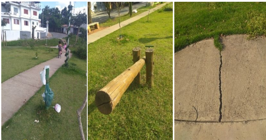
Figuras 25 e 26. Lixeira vandalizada, gangorra sem a alça e o piso danificado no Parque Jaguaribe, Vila Jaguaribe, Osasco, SP.
