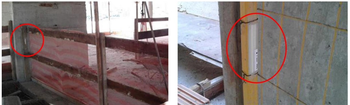
Figuras 22 e 23: RFID instalada em sistemas guarda-corpo rodapé (GcR).
