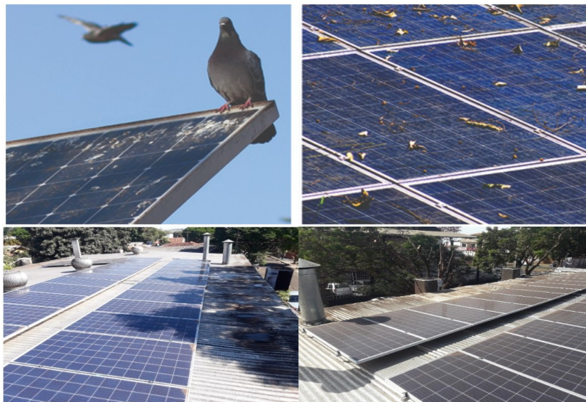
Figura 26 – Degradação por sujeira e sombreamento
