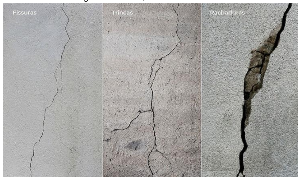
Figura 2: Fissuras, Trincas e Rachaduras
