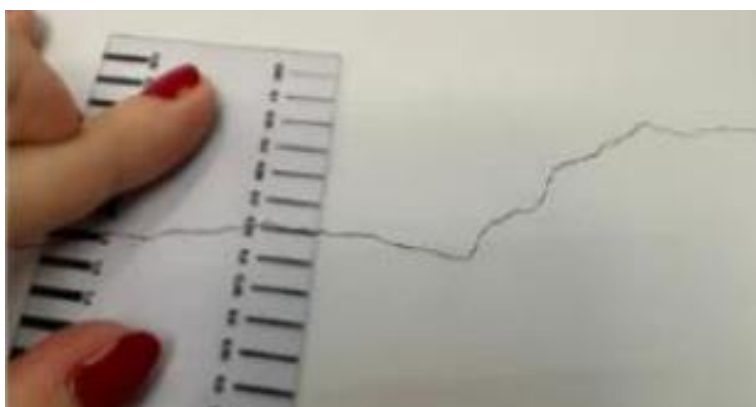
Figura 5: Mensuração de largura de uma fissura
