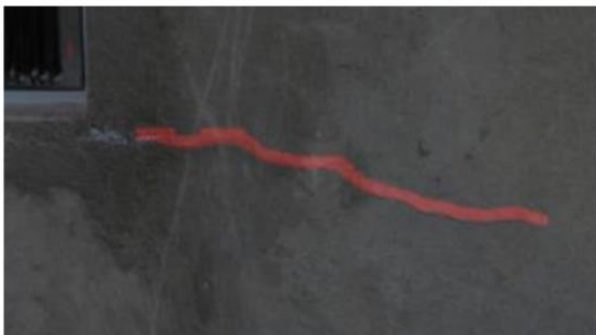
(A) Fissura com a máscara de segmentação
